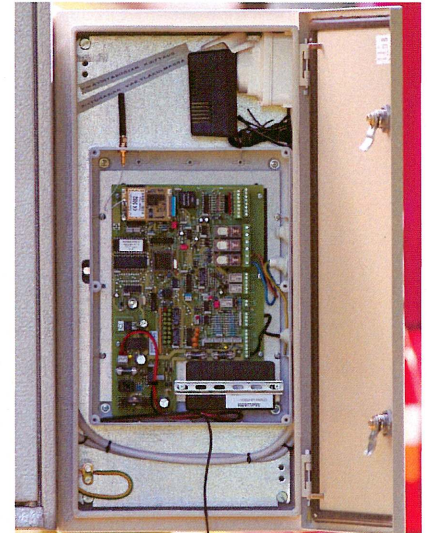
Ala-asema asennettuna katujakokaapin kylkeen.
